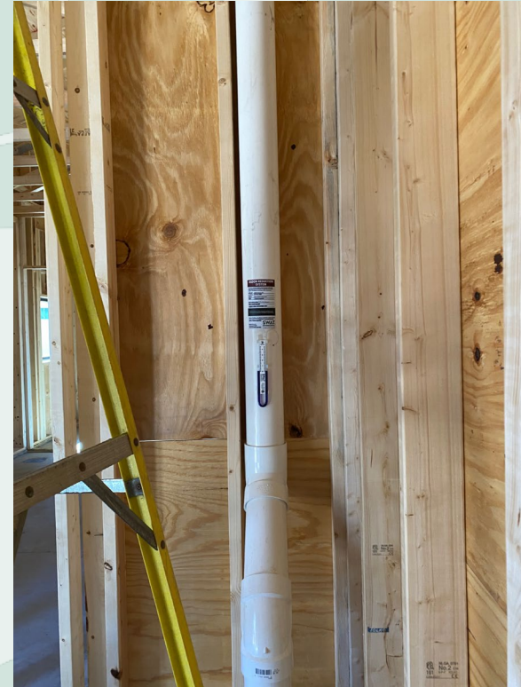
Manometer on riser
