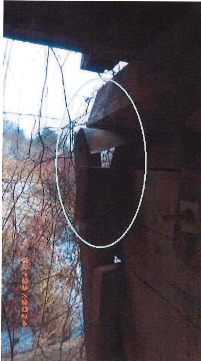
SE Pile Split.
