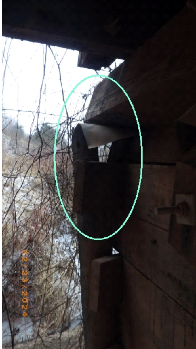
SE Pile Split.
