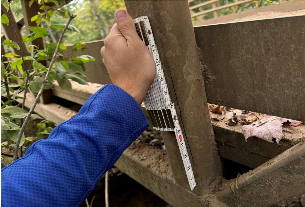
R6 vert crack
