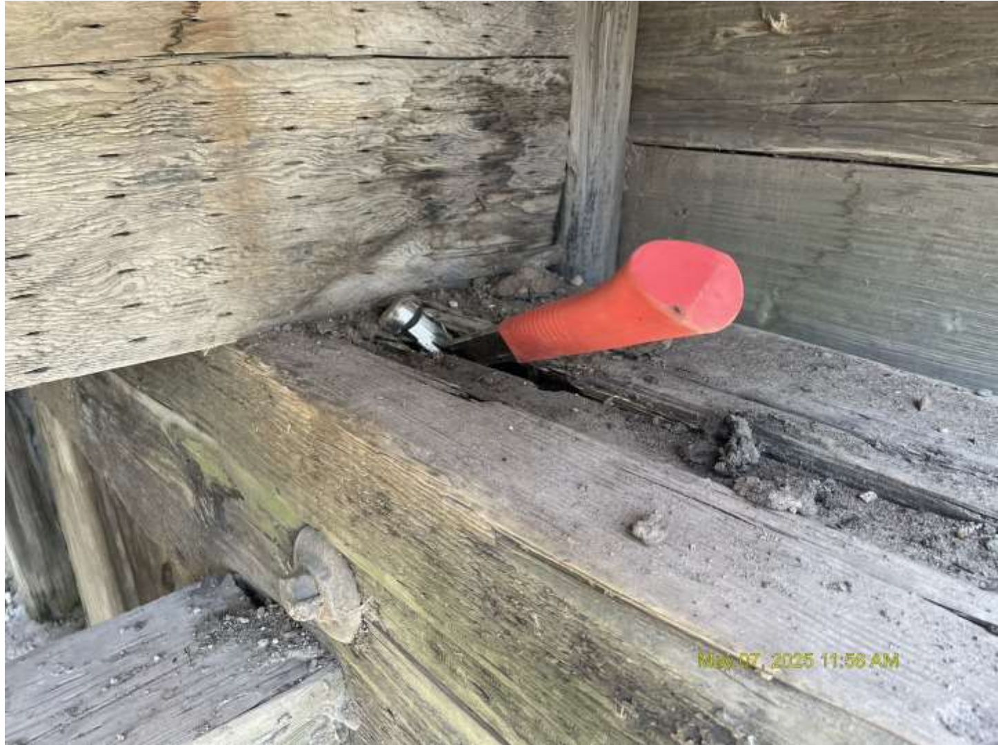
N. Abut. pier cap rotted
