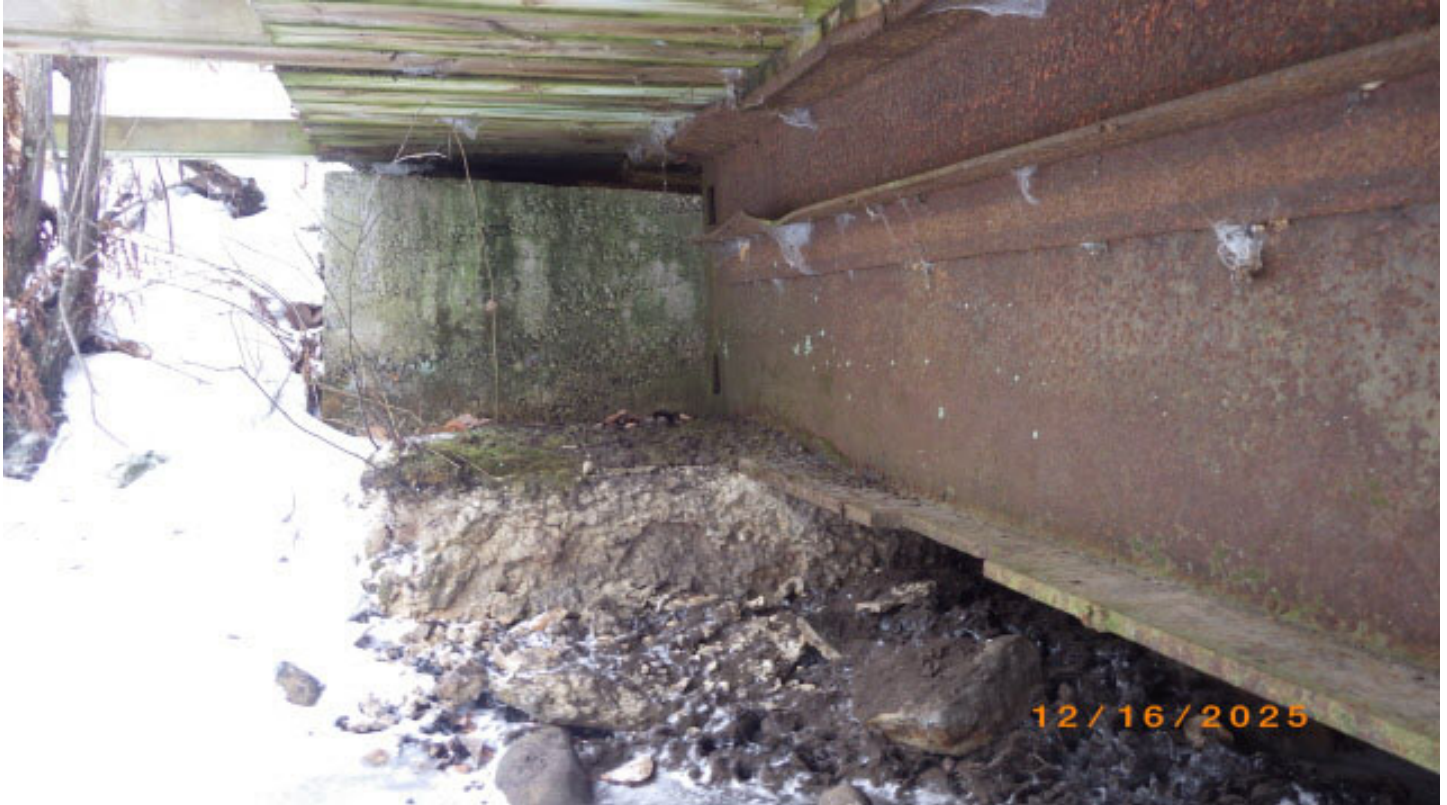
NE sill, CS4 spalling
