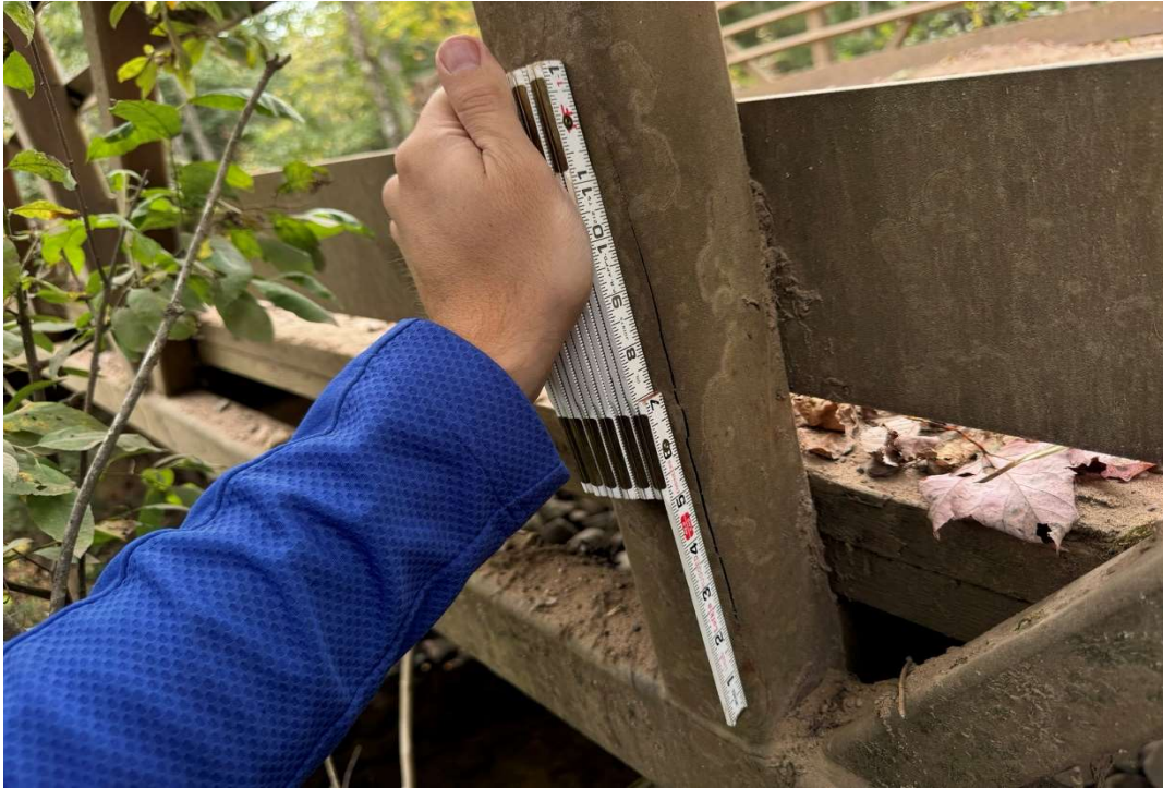
R6 vert crack
