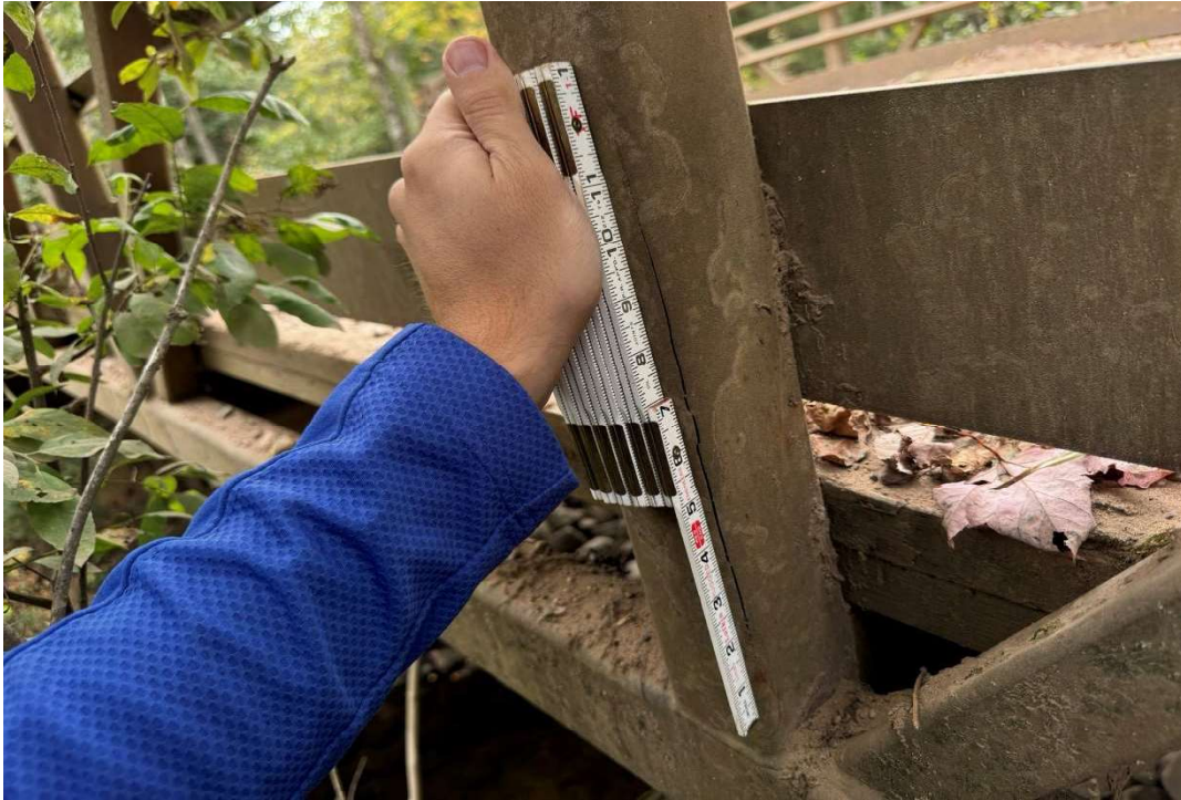
R6 vert crack
