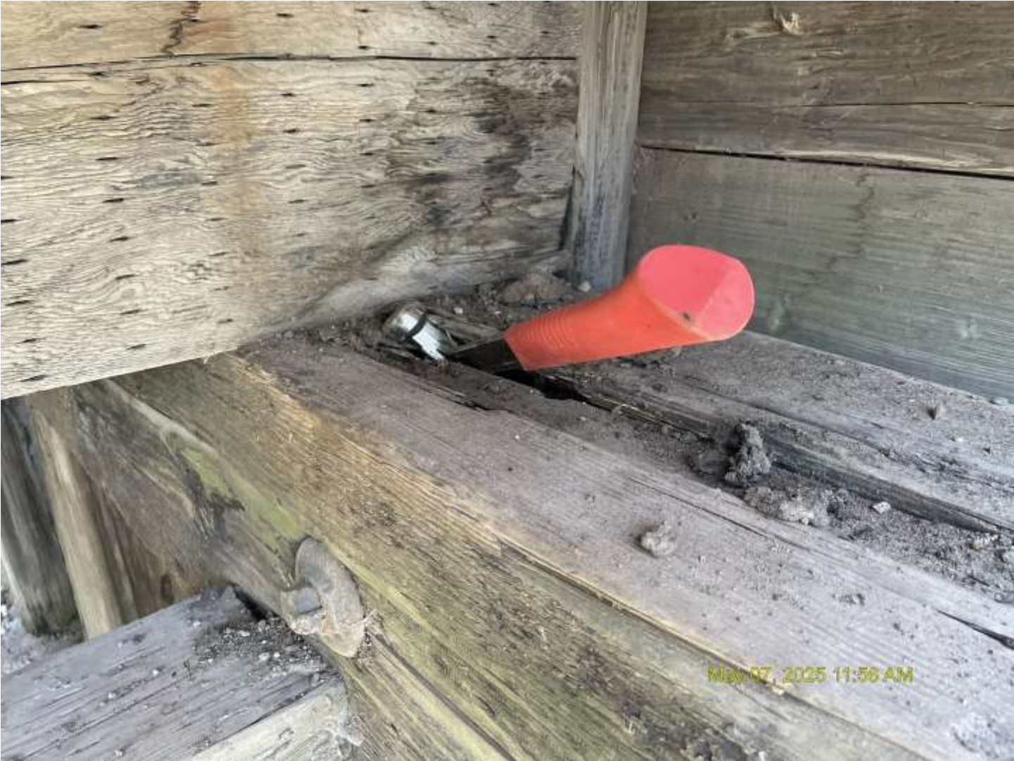
N. Abut. pier cap rotted
