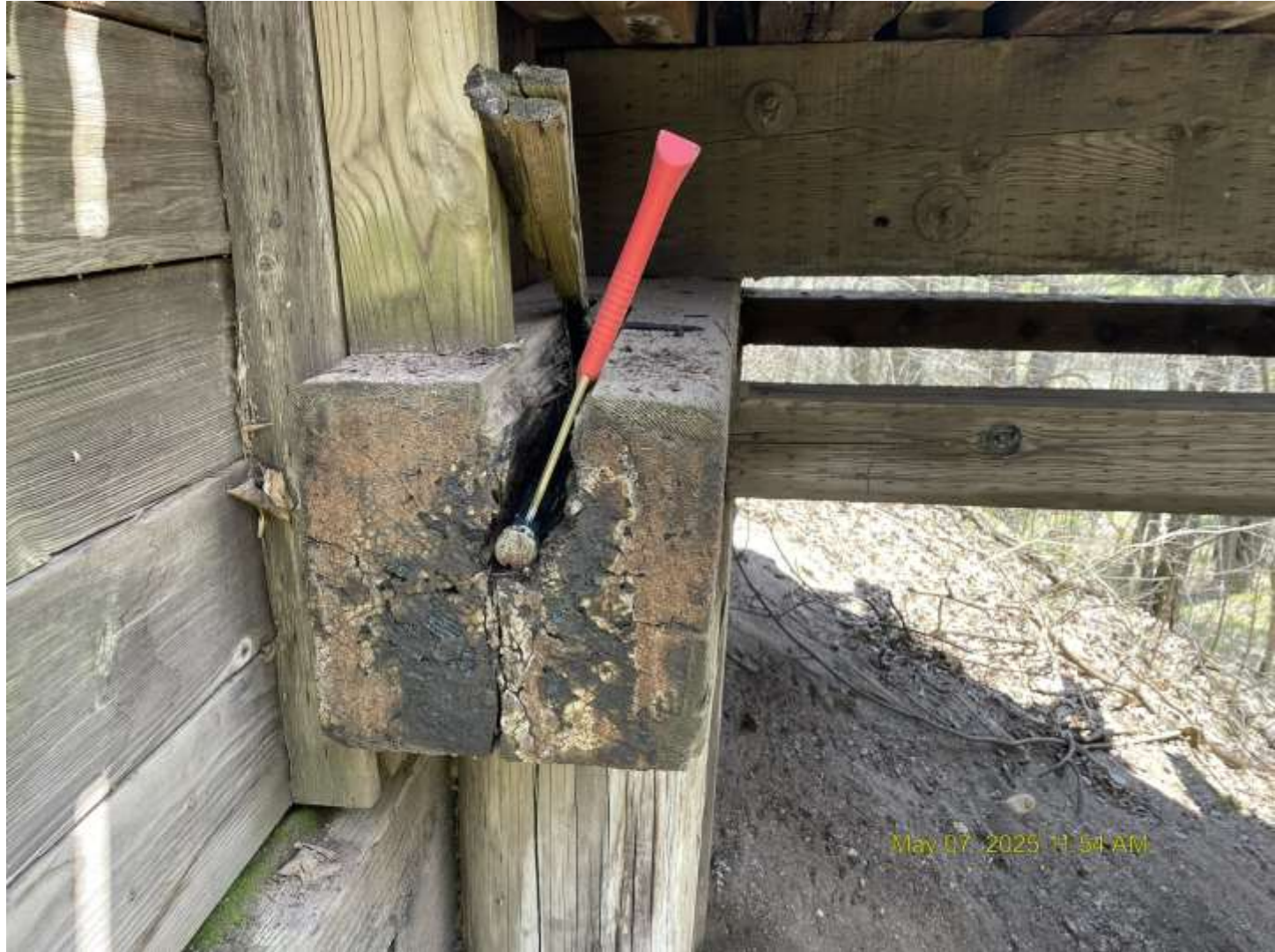
N. Abut. Pier cap rotted
